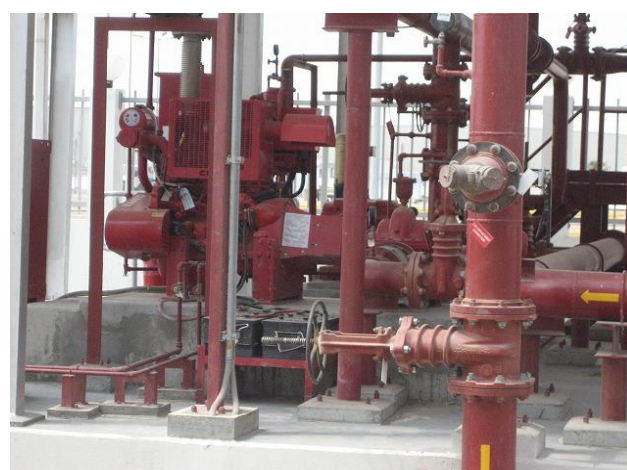
Fire stationのパイプライン
