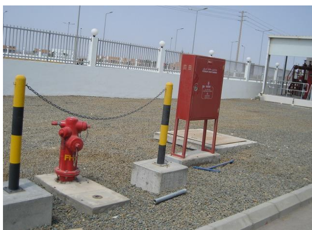
北側の消火栓
