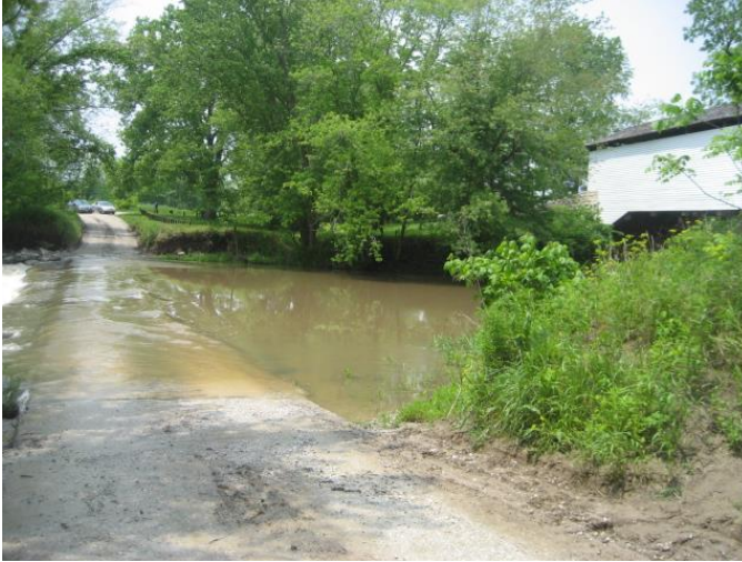
下の道路の橋は冠水していた。
