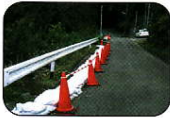
上側道路の陥没と崩落現場
